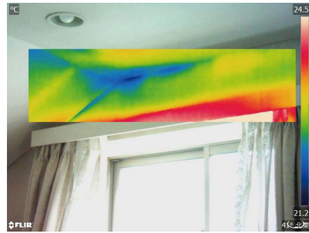
【画像2】壁面内の水分浸入箇所
