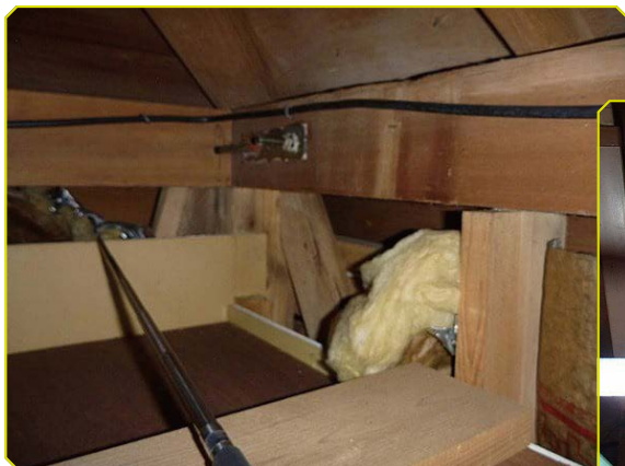
▲雨漏り・筋かいの確認
